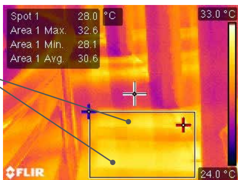
Isola di calore prossima alla facciata (30,6 °C)
